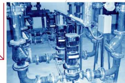
4台TPE泵安装在冷冻水系统中
