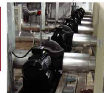
8台HSS泵安装在冷冻二次系统中
